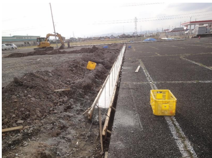
北側隣地との境界に沿ってブロックフェンスを設置します。基礎部分を造っています。
