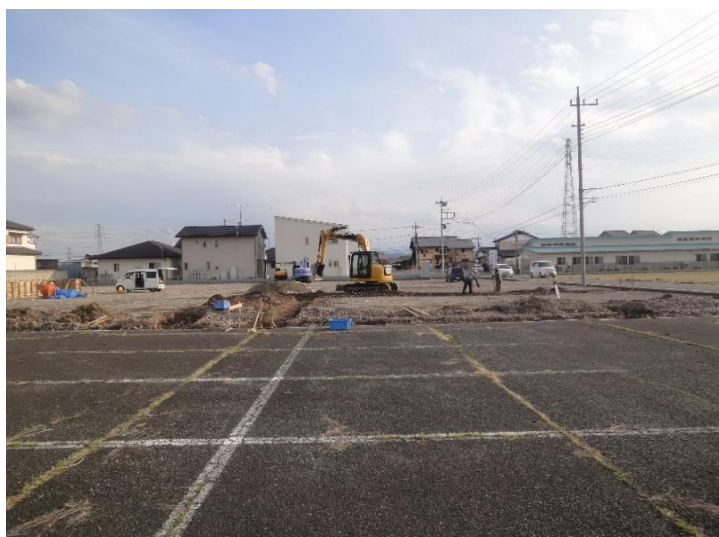
分譲地北側から撮影：1号地から造成が始まりました。全体の造成完了まで2ヶ月を予定しています。
