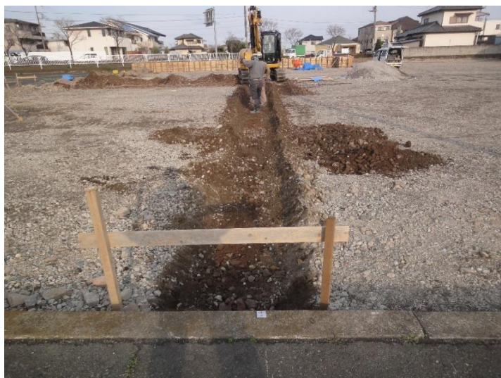
1号地より撮影。ブロックの基礎を造るために土を掘削中です。
