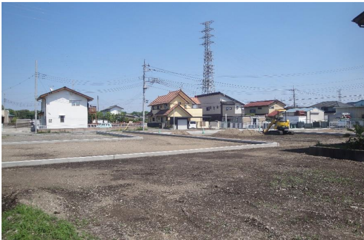
1号地西側から撮影。これから各区画の住宅建築も順次始まります。
