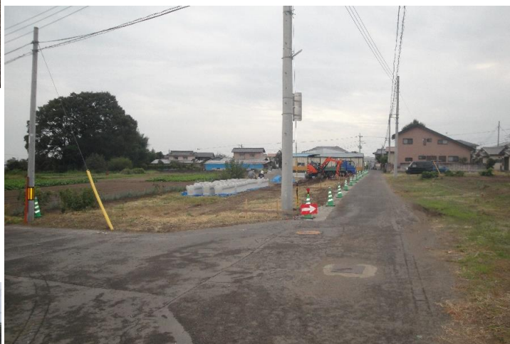
分譲地北側から撮影しました。 カラーコーンがある辺りに道路側溝が布設されます。
