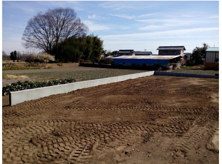
3号地を撮影。 擁壁及びブロック布設工事が完了しました。
