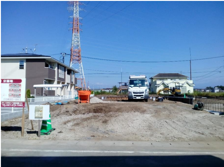
①号地を前面道路より撮影しました。 南道路なので日当たり良好です。
