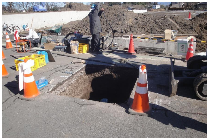
西側道路に消火栓を設置しています。
