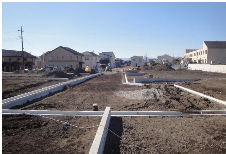
開発道路の形状が出来上がりました。後は下地を作りアスファルト舗装をして完成です。
