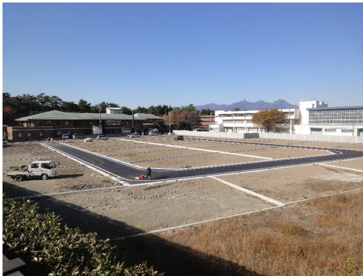
【南東側から撮影】 下水道工事が終了し、下水管内を清掃しています。
