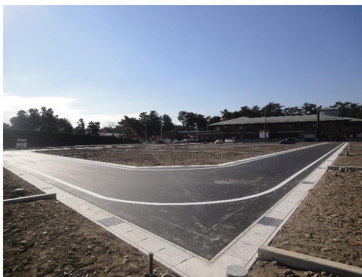
舗装工事が完了し白線も引き終わり、開発道路 が完成しました。
