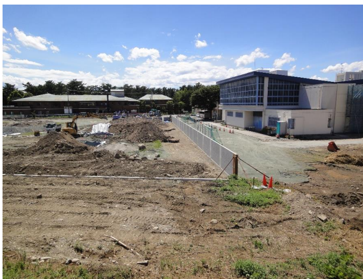
北側の学校側の境界ブロック工事は、もう少しで完成のようです。
