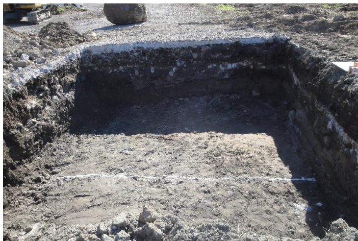
28号・29号地：雨水浸透槽を設置しています。幅3.5(4.0)m、奥行き6.0m、高さ2.1mのサイズで2区画分です。
